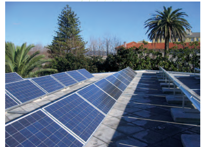
Instalación fotovoltaica no CCU de Ferrol
