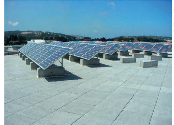
Instalación solar fotovoltaica do Centro de Investigación en Tecnoloxías da Información e das Comunicacións (CITIC), de 9 kWp, 2008.
